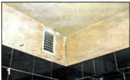
Грибок на потолке и стенах — результат промерзания стены в ванной комнате. Общее состояние помещения и оборудования ванной комнаты требовало ремонта.
