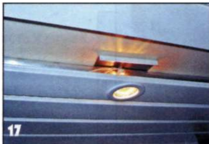
Галогенные лампы подключены через специальный трансформатор. Между лампами и утеплителем на потолке я установил тепловые экраны из обрезков реек подвесного потолка.
