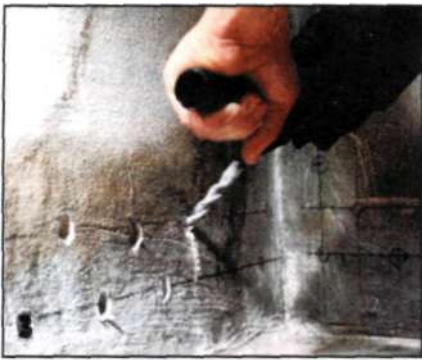
Чтобы сверло не скользило по поверхности стены, сначала в штукатурке под прямым углом сверлят небольшие углубления, а затем кладку сверлят под наклоном на глубину примерно 2/3 толщины стены.
