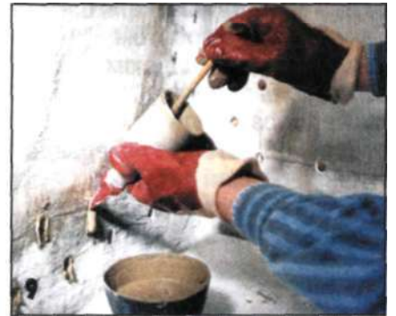
Деревянным стержнем круглого сечения трамбуют раствор в отверстиях до полного их заполнения.
